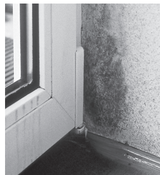
Schimmelpilzbefall infolge ungenügender Belüftung. – Moisissure provoquée par une aération insuffisante.
